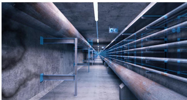
图二 地下管廊实景图
